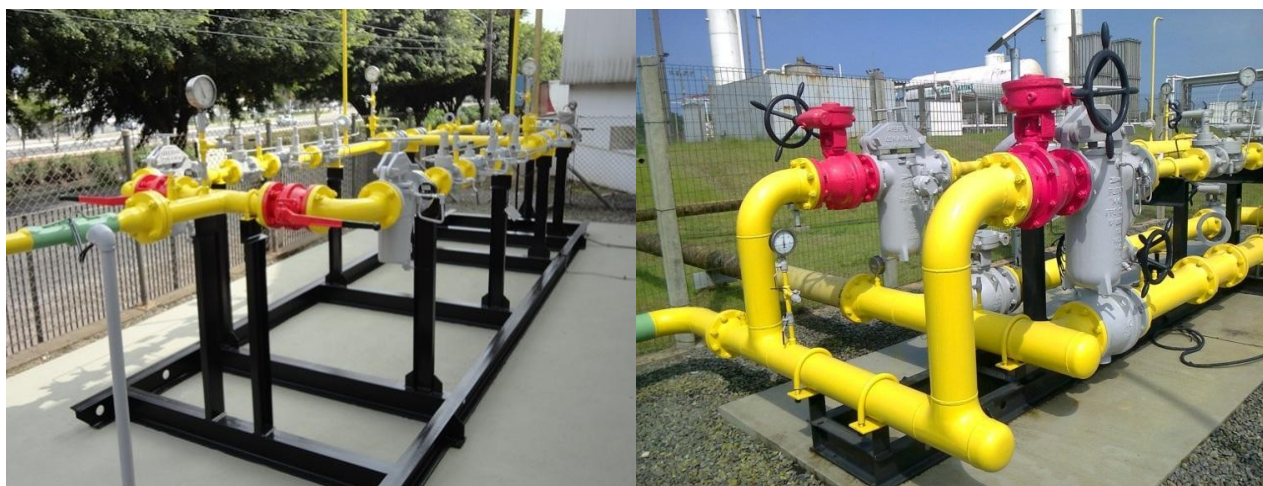
Figura 1: Válvulas de fechamento de gás em edificações.
