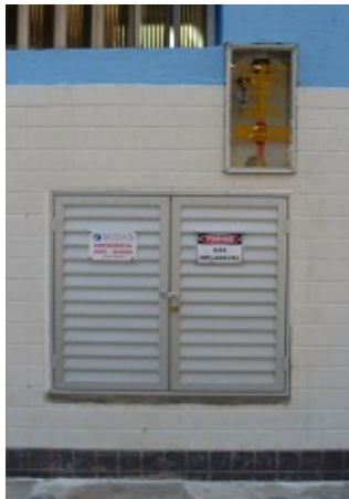
Figura 3 – Instalação da Estação de GN em fachada de edificação Fonte: SCGÁS
