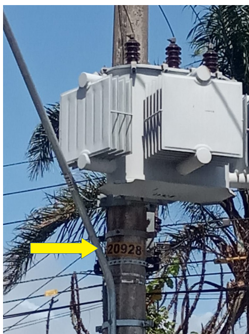
Número de identificação do transformador: 20928
